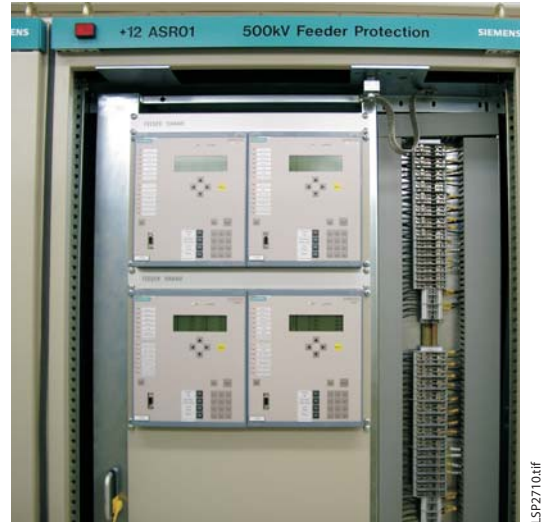
Bild 3 Haupt- und Reserveschutz 7SD523/7SA522 an der Einspeisung zweier Kraftwerksblöcke
