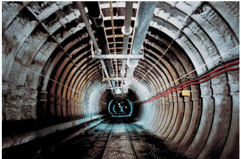
Bild 5 Stromversorgung im Stollen
