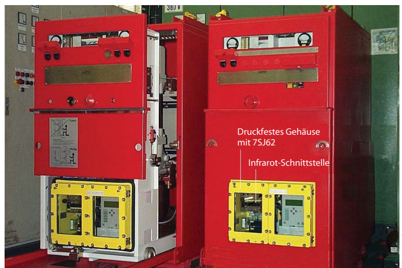
Bild 2 Gekapselte Schaltanlage Siemens Bartec 8SN
