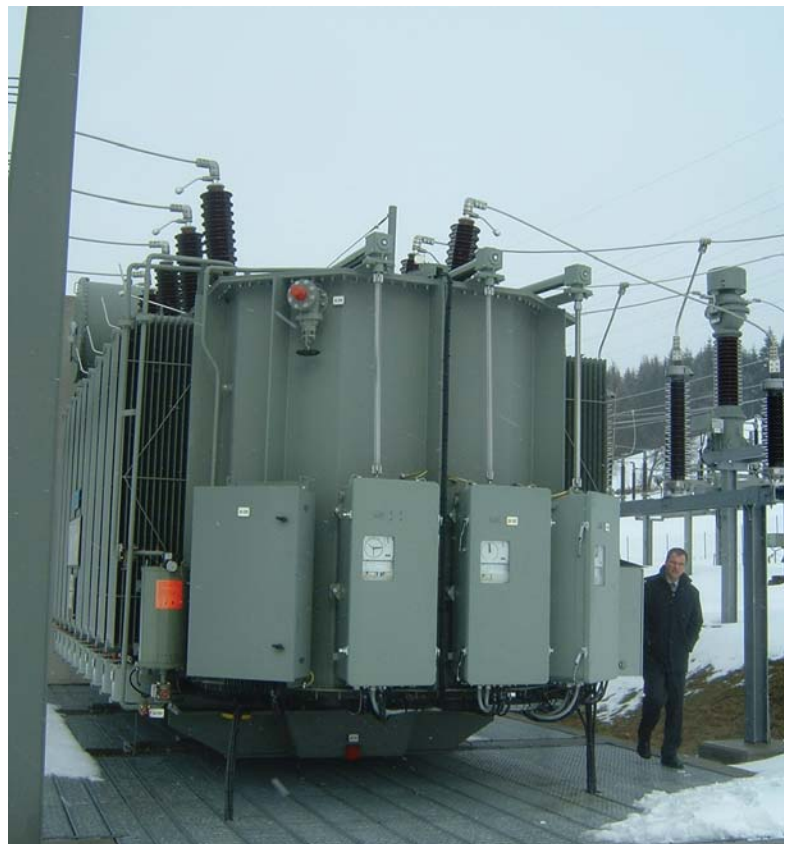
Bild 1 Schrägregeltransformator der Überlandwerke in Kempten
