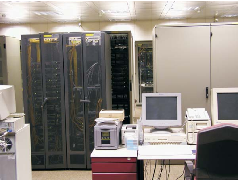
Fig. 3 DEVK data center
