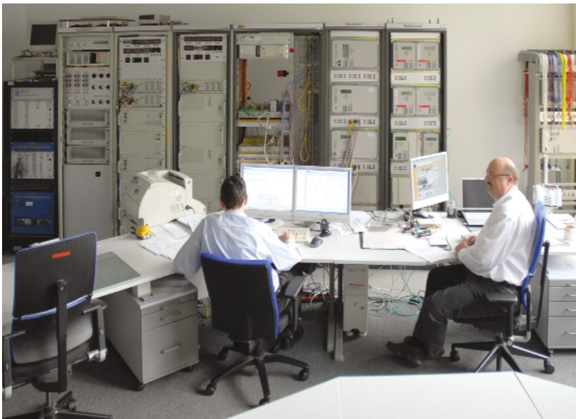
Die technische Ausstattung des Simulators mit RTDS, Verstärker, Signalverteiler und Schutzgeräten (v.l.n.r.)
