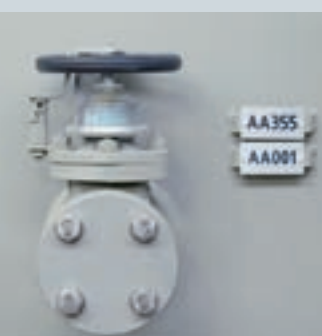
Válvula de vazamento
